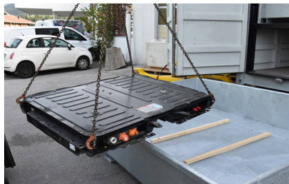
Energiespeicher im Behälter platzieren
